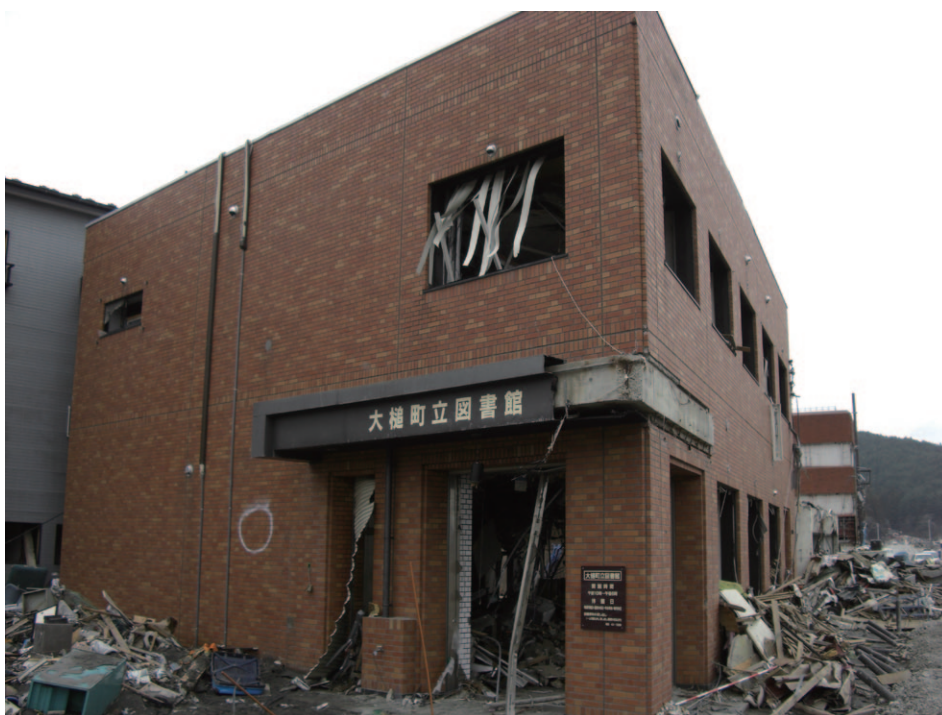
津波により壊滅的な被害を受けた大槌町立図書館(岩手県立図書館提供)
