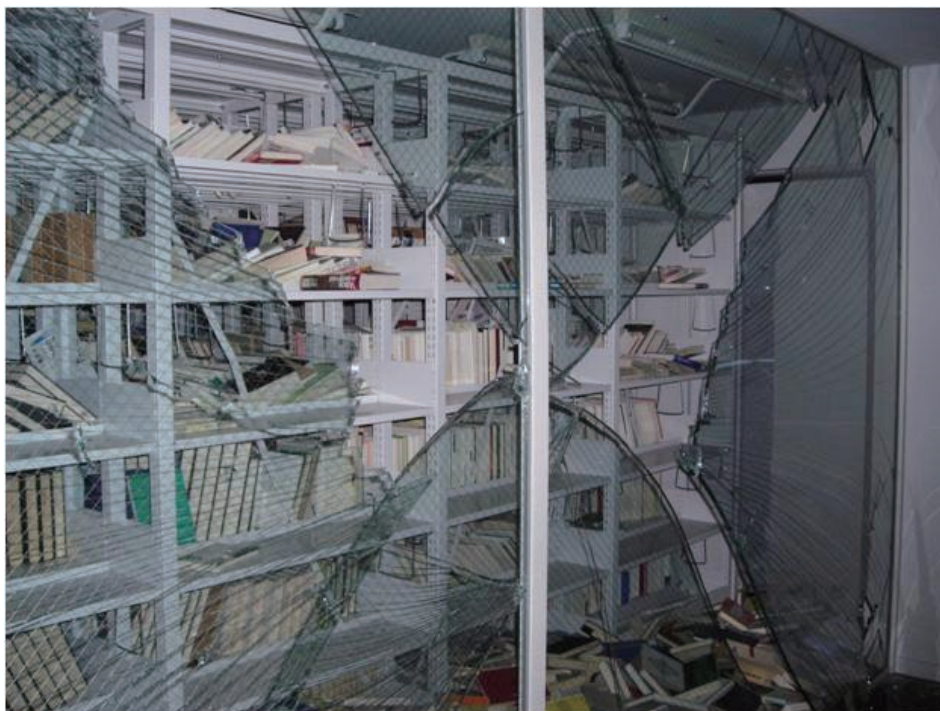
地震で破壊された宮城県図書館のガラス壁(宮城県図書館提供)
